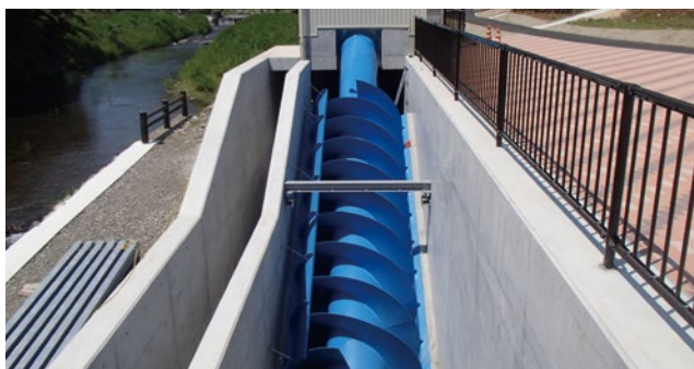
小鷹井堰に設置されたらせん水車
